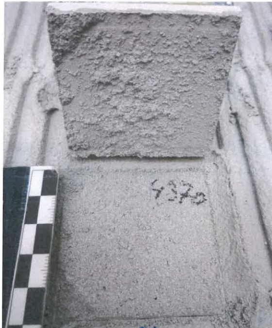
Bild 1: Exemplarisches Bruchbild der Haftzugprüfung Nr. 2 des Prüfkörpers FL 1
