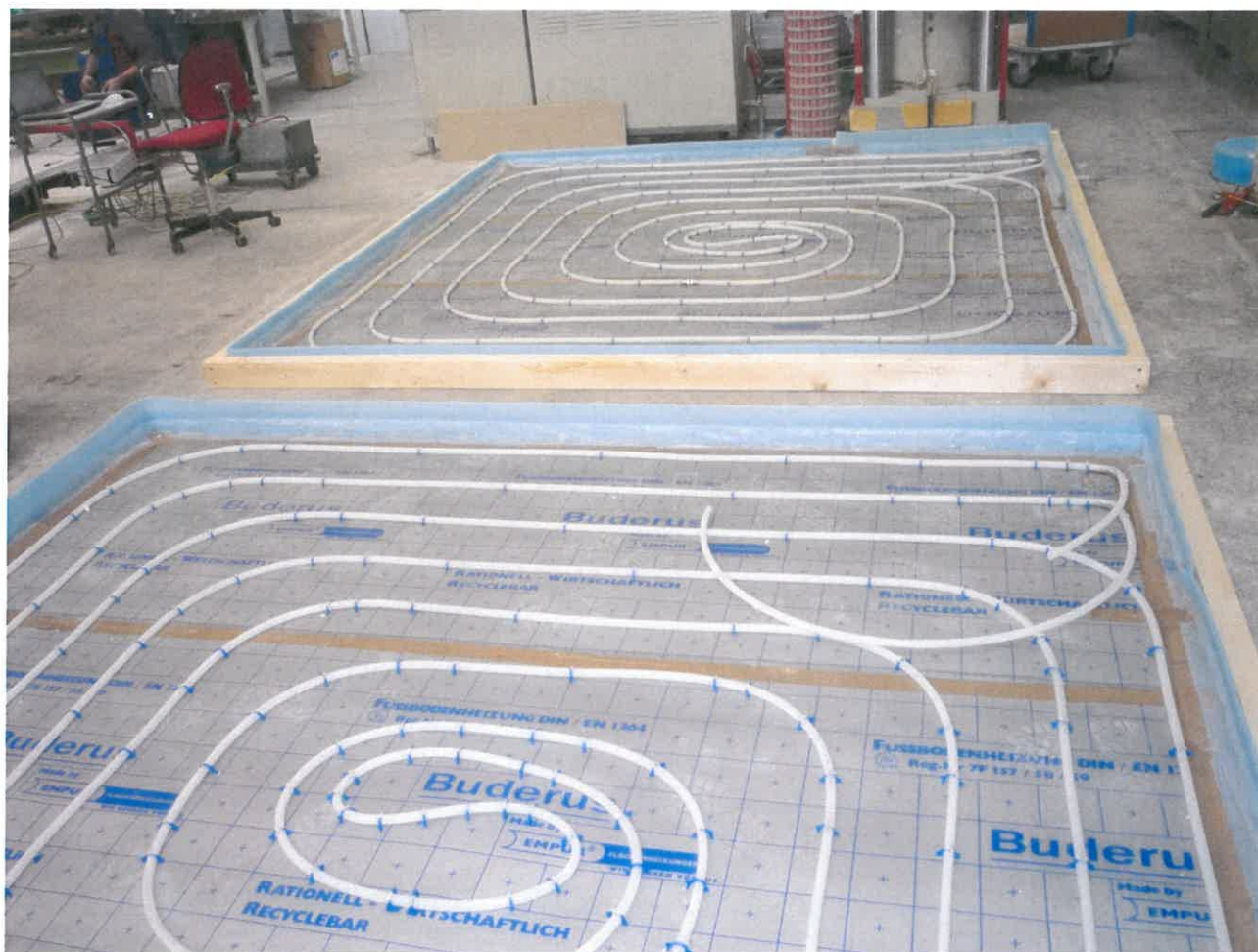
Bild 1: Fußbodenheizung in den beiden Musterflächen
