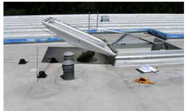
Kollision Rauchabzug mit Blitzschutzsystem.
