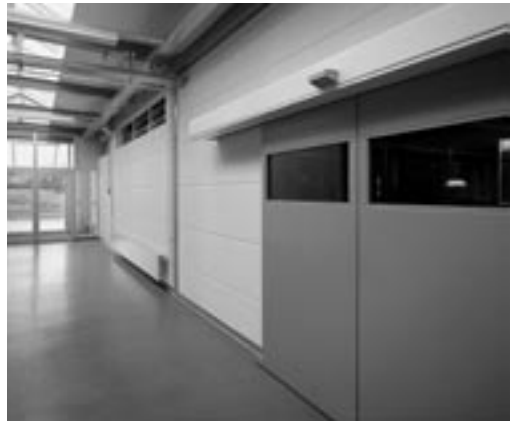
Brandwand aus HEBEL Brandwandplatten.
