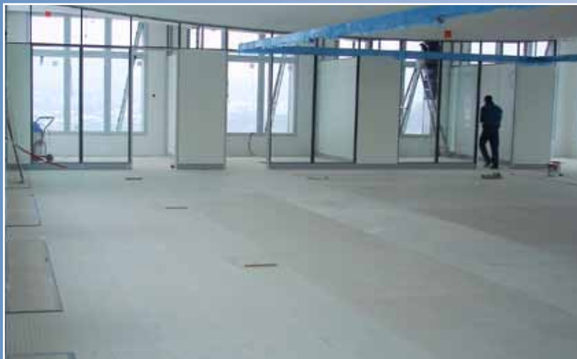
MERO Hohlboden Combi T im Barmenia Bürogebäude
