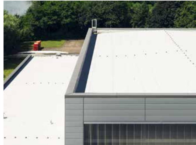
STEAG New Energies GmbH, Saarbrücken
