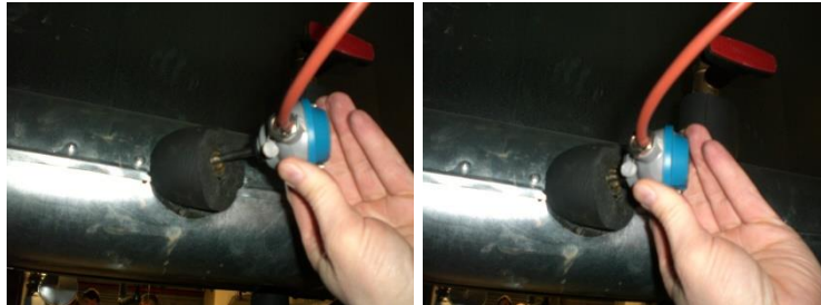
Abbildung 5 und 6: Fühler ist nicht verplombt und in nicht zulässiger Tauchhülse installiert
