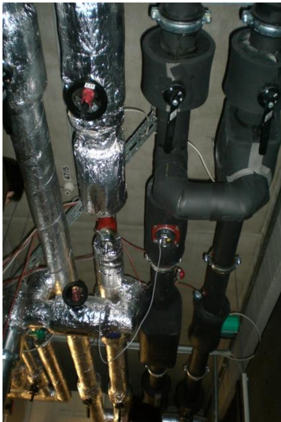
Abbildung 1: LA 17 Wärme- und Kältezähler unter der Decke kopfüber montiert
