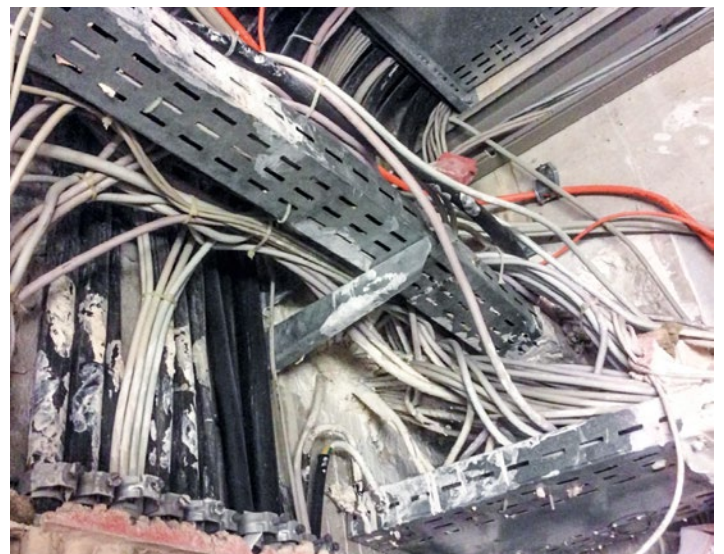
Nicht fachgerechte Kabelbeschriftung und Kabelbündelung
