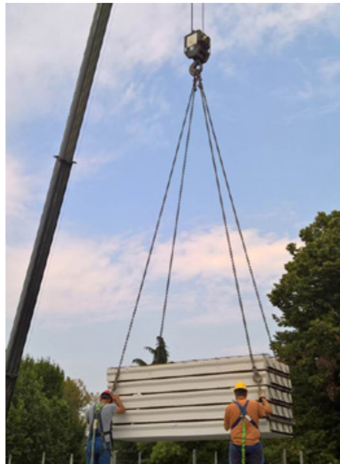
Dank der Leichtigkeit von Airfloor™ können mehrere Platten gleichzeitig angehoben werden, wodurch das Handling beschleunigt wird.
