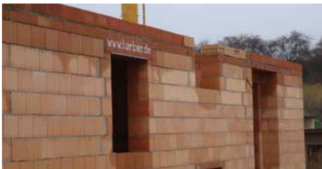
Abb.3 Winterbaustelle mit starkem Feuchteintritt im Ziegelmauerwerk
